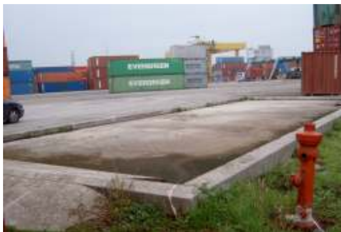
VASCA DI CONTENIMENTO PER FUORIUSCITA PRODOTTI /SOSTANZE PERICOLOSE
