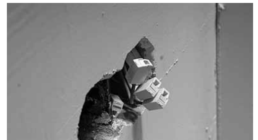
Fig. 8: i cavi elettrici che escono dalla parete sono isolati.
